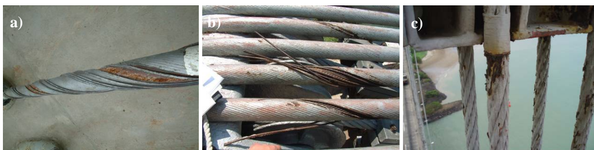
Figura 9. a) Rotura de alambres en un tirante de cable cerrado; b) Rotura de alambres por corrosión en el puente de Amposta; c) Corrosión en péndolas del puente de las Américas.
