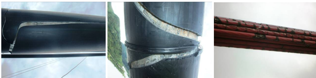
Figura 8. Agrietamientos en vainas de protección de tirantes antiguos correspondientes a dos tecnologías diferentes.
