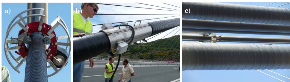
Figura 10. Reparación de vainas mediante encintado con banda elastomérica: a) Máquina de encintado; b) Tratamiento térmico de vulcanizado in situ; c) Aspecto de dos tirantes encintados.
