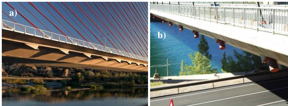
Figura 2. Anclajes de tirantes bajo el tablero en los puentes de: a) Talavera de la Reina (Sánchez de León et al., 2012); b) Carlos Fernández Casado (Manterola et al., 1984).
